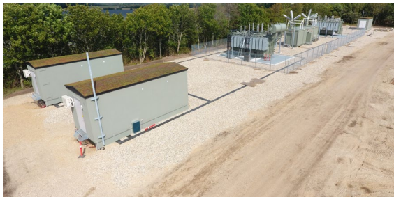
Teknikhuse og transformer
